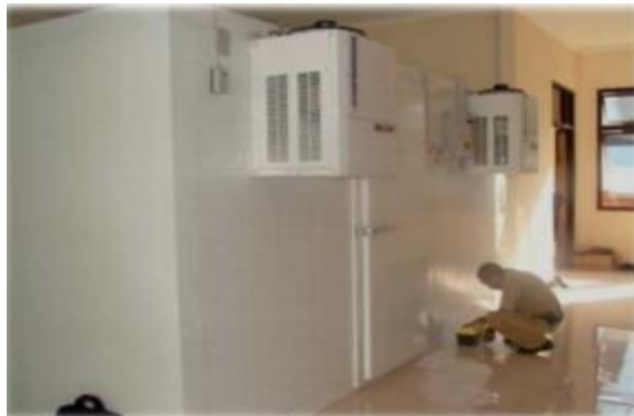
Gambar 2.1 Cool Room atau Freezer Room (CDOB, 2015)
